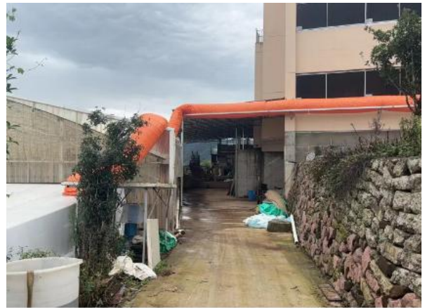
异位发酵床废气到 BEM 的管道
