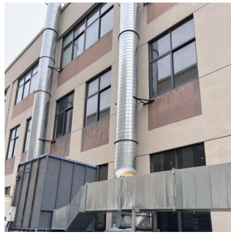
废气处理设施
