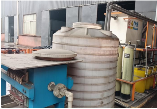
废水处理设施
