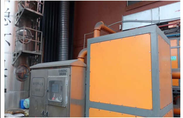
废气处理设施
