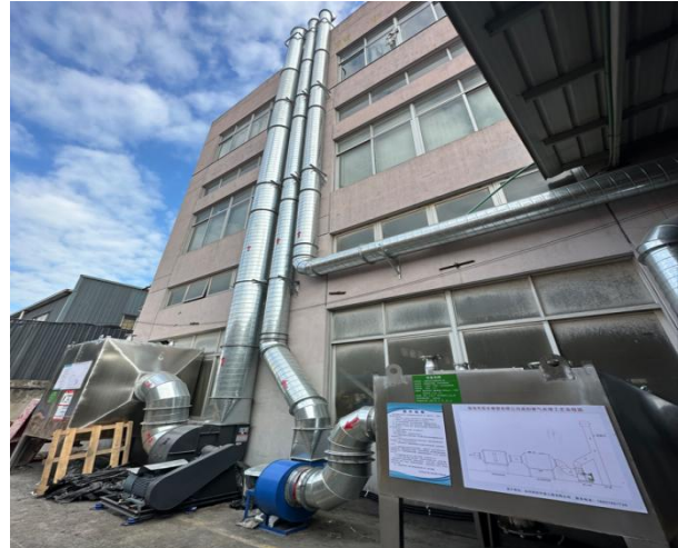
PVC 挤出、涂塑废气排气筒
