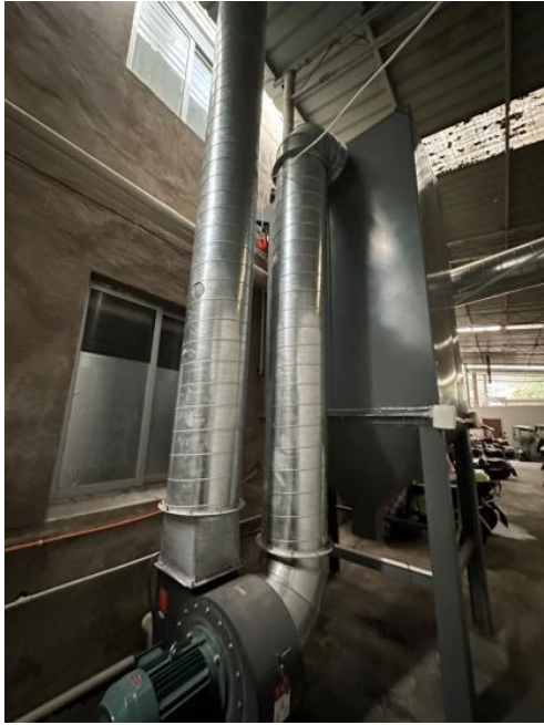
布袋除尘器排放口
