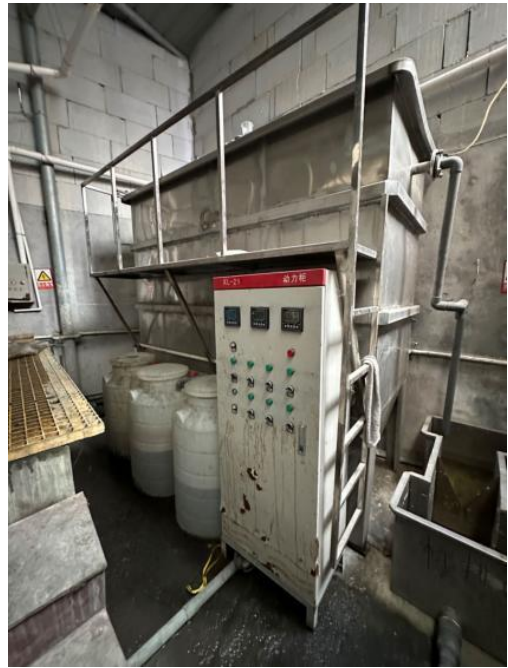
废水处理设施及标排口
