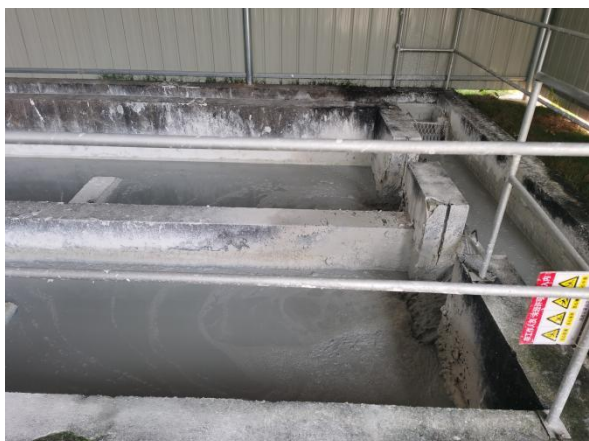
废水处理设施
