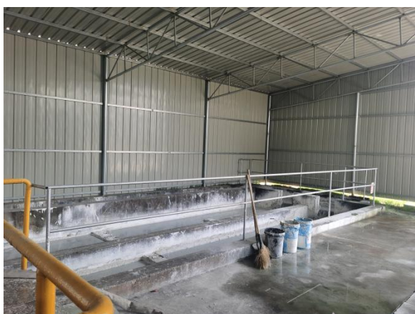
废水处理设施
