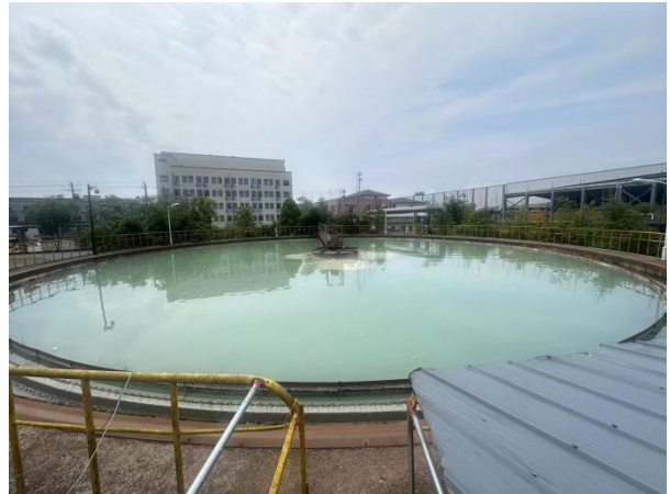
废水处理沉淀池
