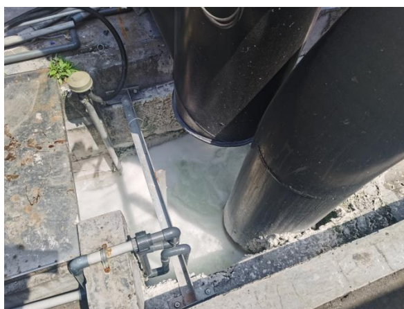
废水处理设施标排口
