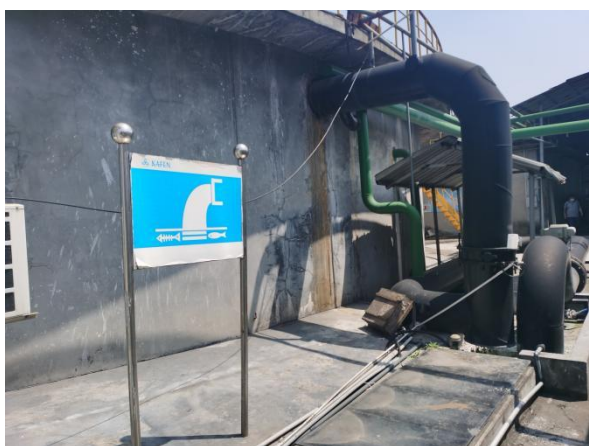
废水处理设施标排口
