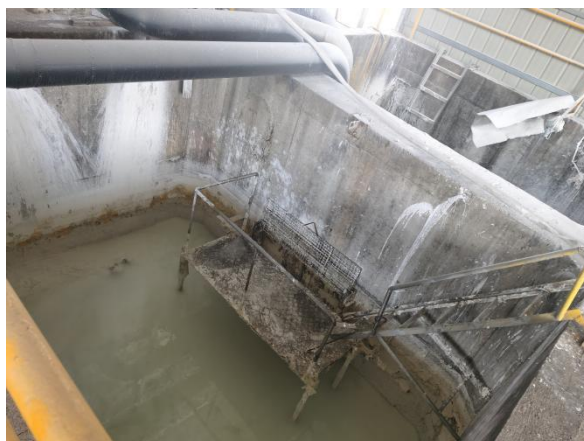
废水处理设施
