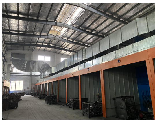
打磨废气收集、袋式除尘器
