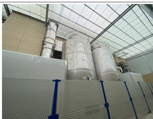
脱蜡废气臭氧氧化+二级喷淋塔（左） 制蜡、蜡模焊接废气臭氧氧化+二级喷淋塔（右）
