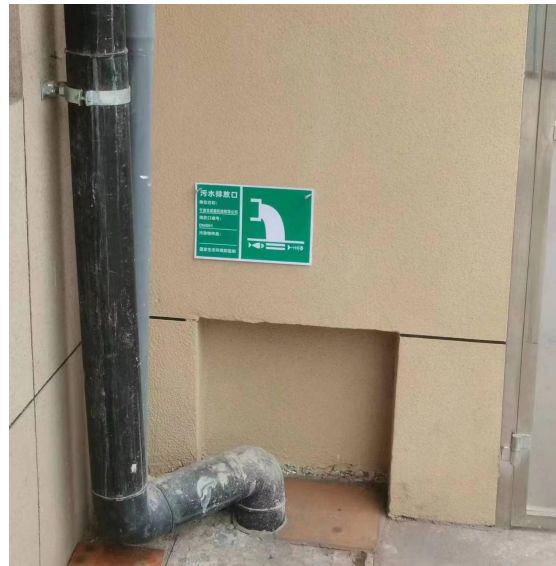
生活污水排放口
