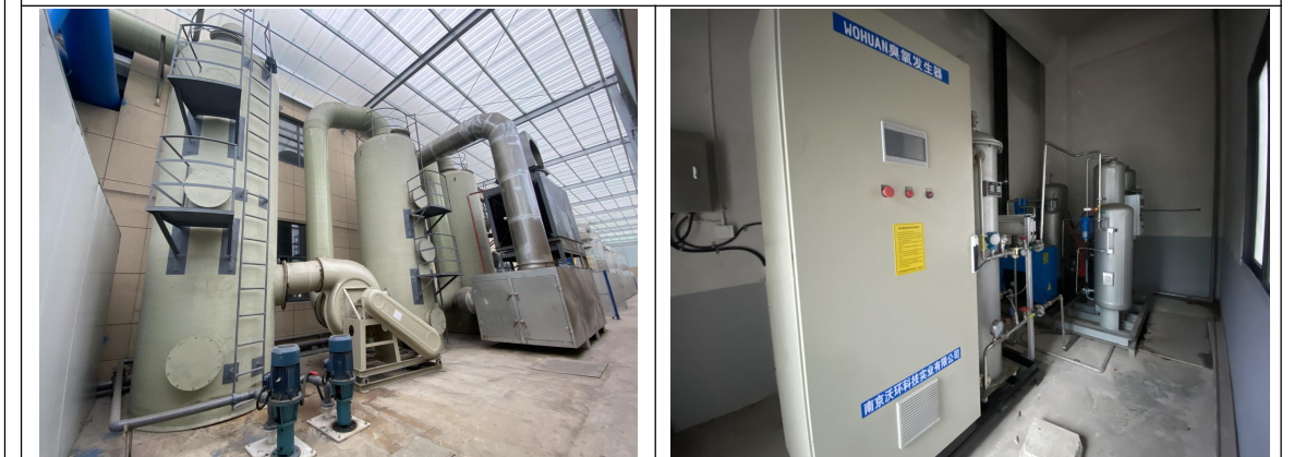
焙烧废气高温冷却+臭氧氧化+三级喷淋塔
