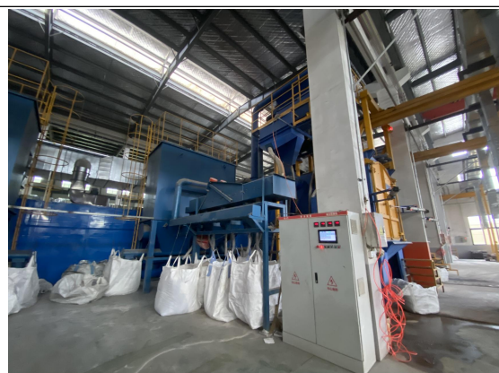
脱壳废气袋式除尘器
