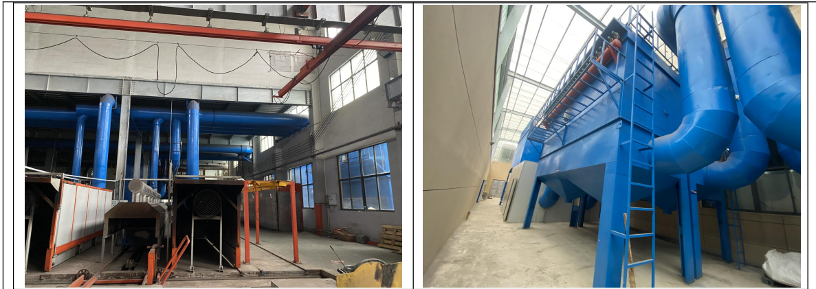
硅溶胶浇铸废气收集、耐高温袋式除尘器
