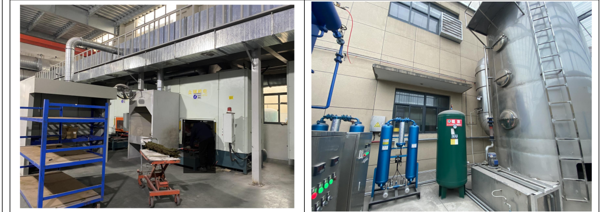
射芯废气收集、臭氧氧化+二级喷淋塔
