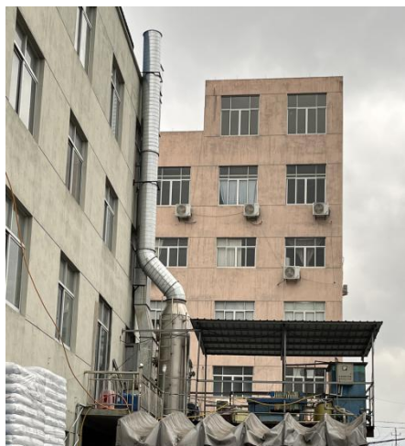
强化、防雾、烘干废气排放口
