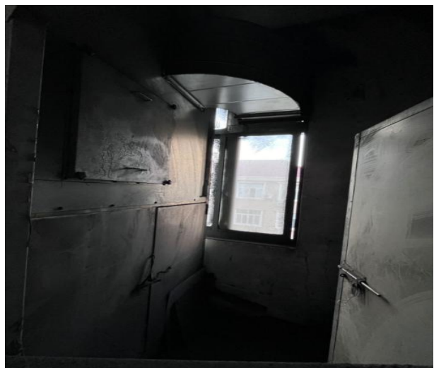
布袋除尘设施
