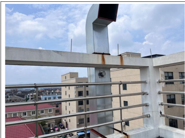
抛光废气排气筒
