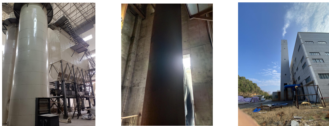
图 4-2 废气处理设施（左）及排气筒（右）
