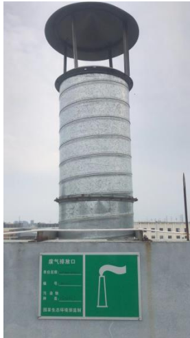
焊接烟尘排放口
