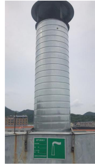
固化、燃烧排放筒
