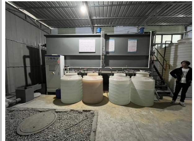
废水处理设施
