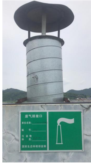
喷塑粉尘排放口
