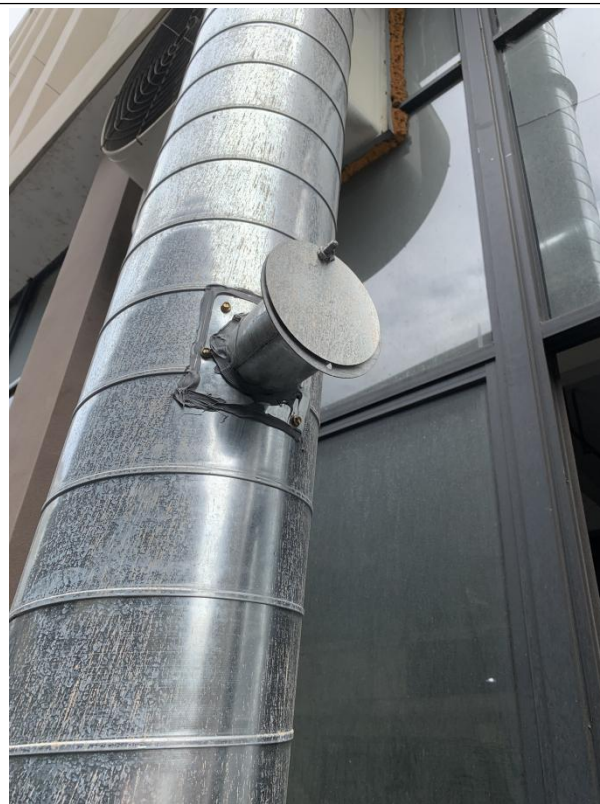
注塑废气采样口
