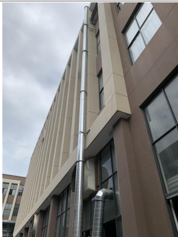
注塑废气排气筒
