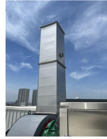
注塑废气排放口
