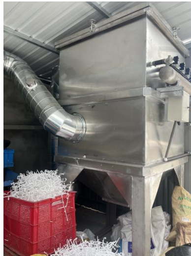
破碎粉尘处理设施（布袋除尘器）
