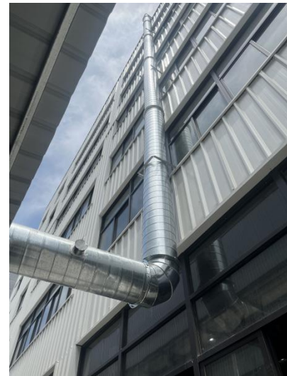
破碎粉尘废气排放口
