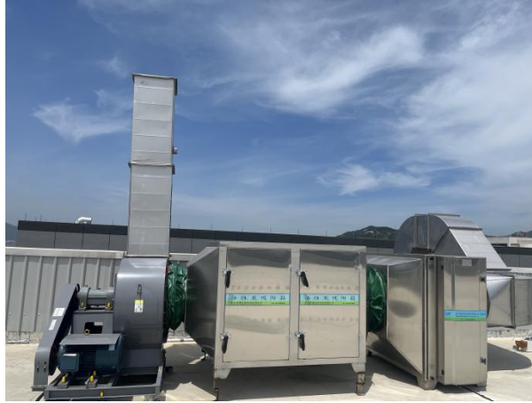
注塑废气处理设施（UV 光催化+活性炭吸附）
