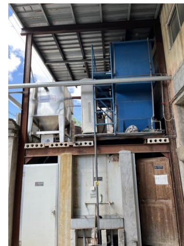
废水处理设施
