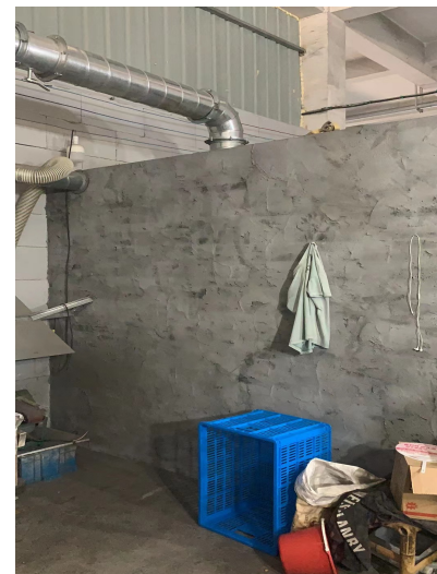
危废房内废气收集处理排放
