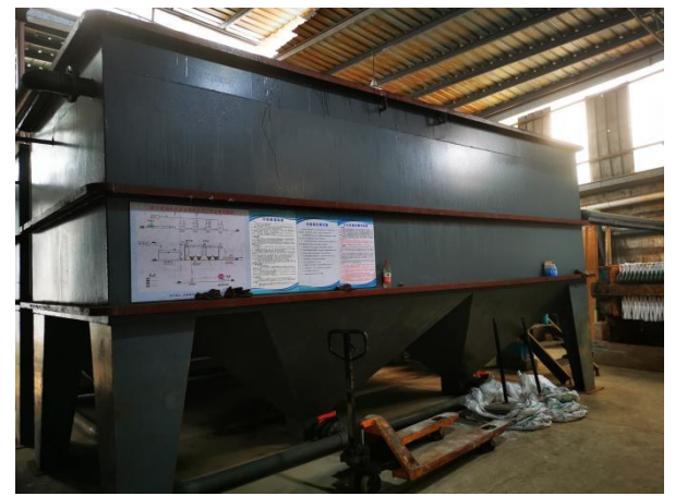
废水处理设施
