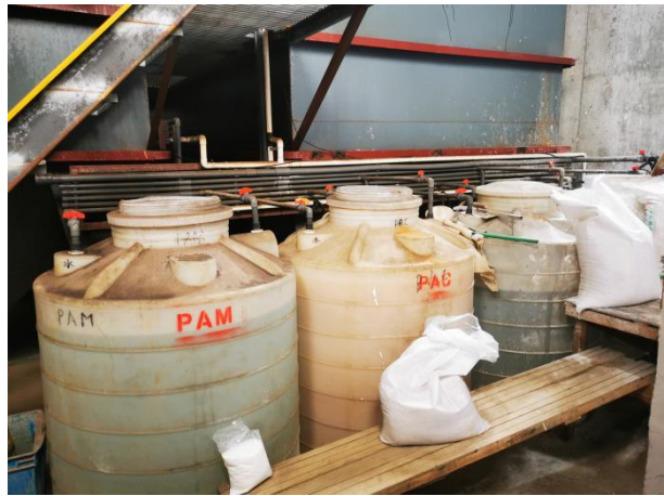
废水处理设施-加药桶
