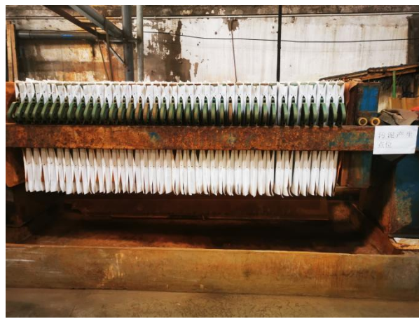
污泥板框压滤
