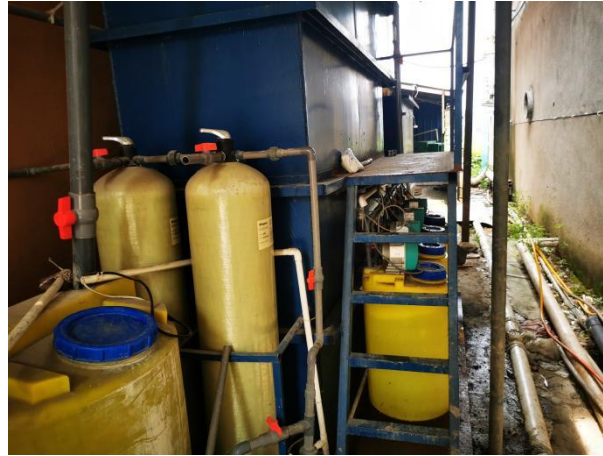
废水处理设施
