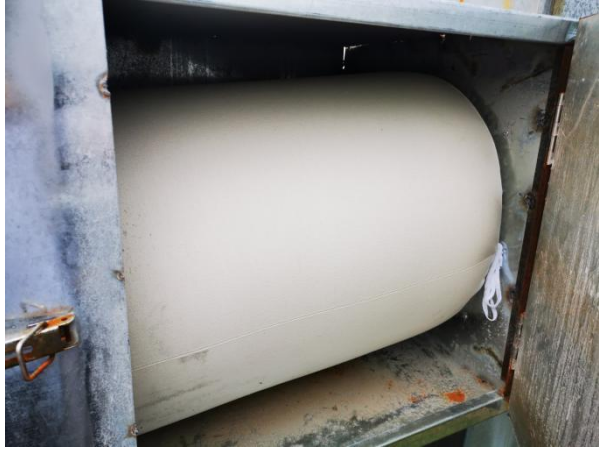
拉砂磨水口废气处理设施--布袋
