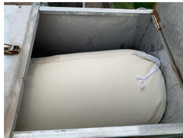
拉砂磨水口废气处理设施--布袋
