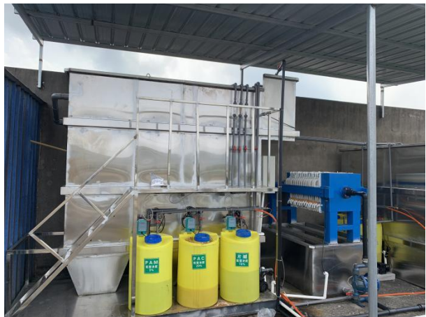
废水处理设施
