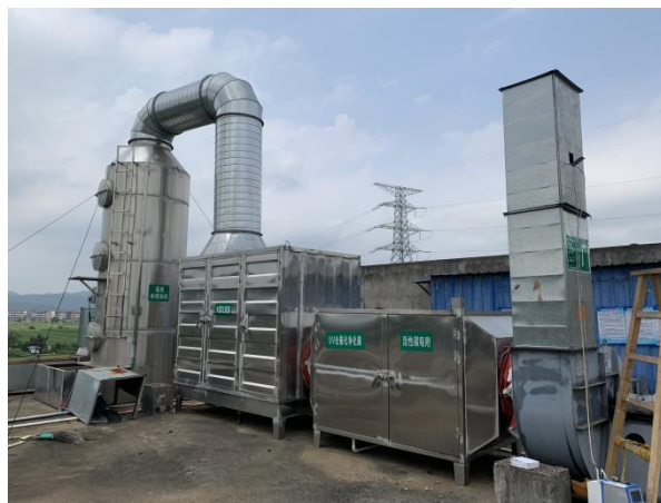
喷漆废气处理设施（水喷淋+过滤棉+光催化氧化+活性炭吸附）
