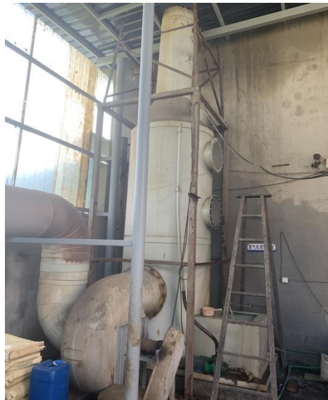
酸洗废气排放口(离地高度 15m)
