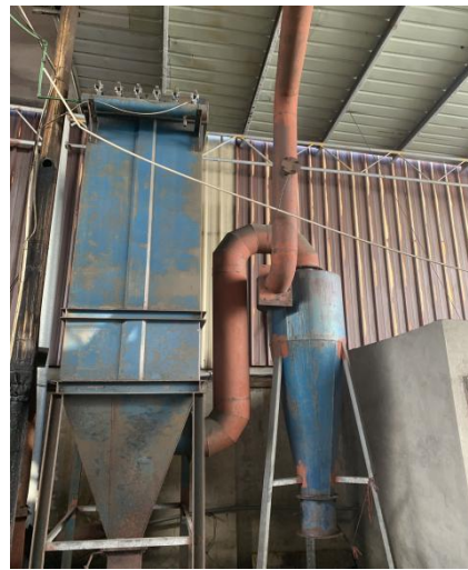
烘干固化废气排放管道
