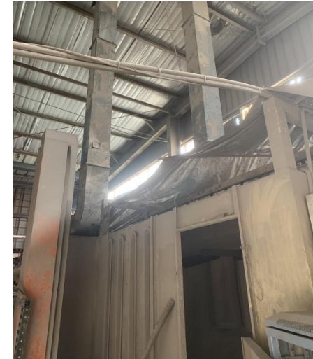
喷塑废气排气筒
