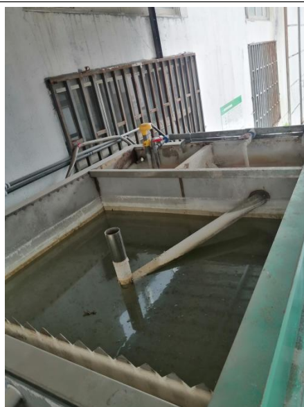
废水混凝沉淀池
