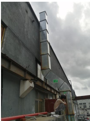
油漆废气排放口
