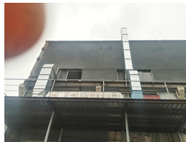
喷漆废气处理设施（水喷淋（水旋流）+过滤棉+光催化氧化+活性炭吸附）
