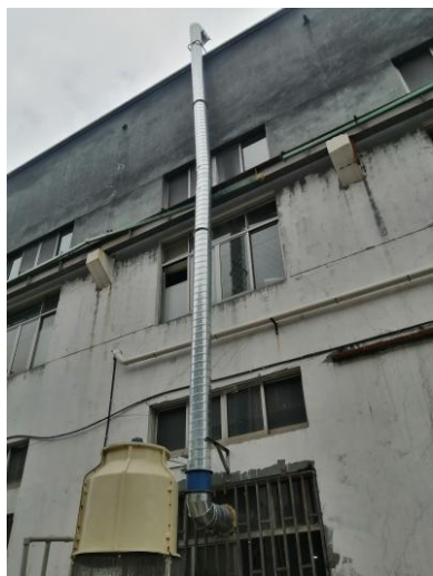
注塑废气排气筒
