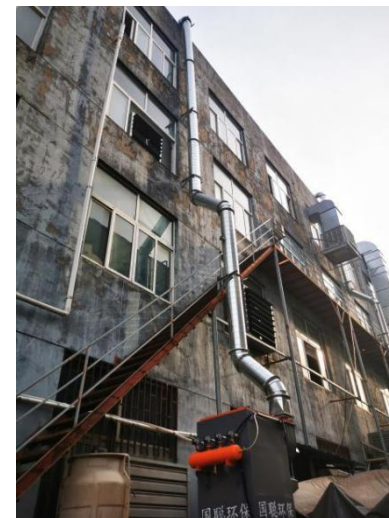
磨边废气处理设施（布袋除尘器）
