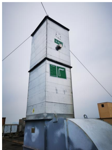
喷漆废气处理设施--排放口
