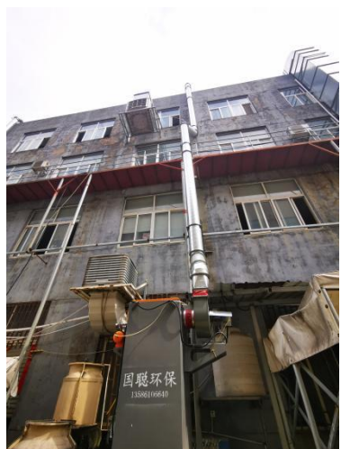
拉砂磨水口废气处理设施--布袋
