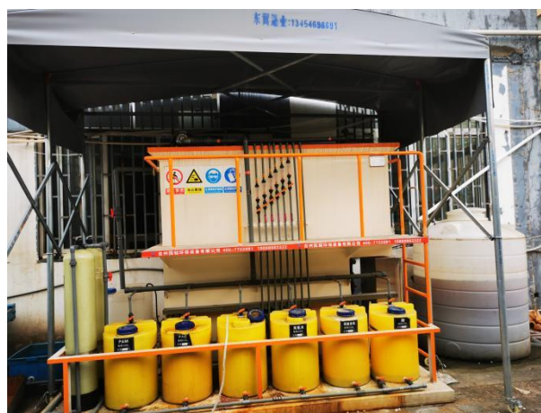
废水处理设施
