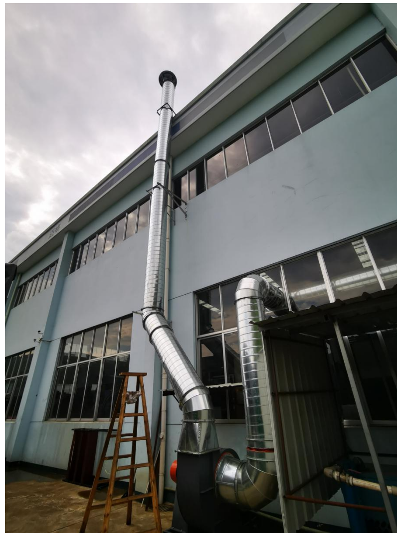
注塑废气排气筒
