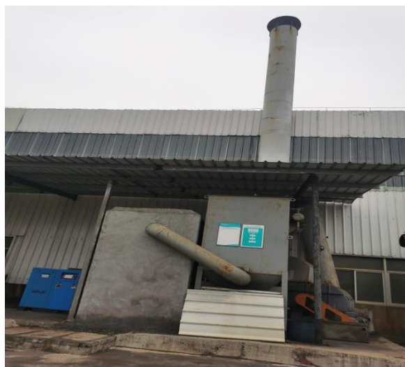
熔化烟尘处理设施
