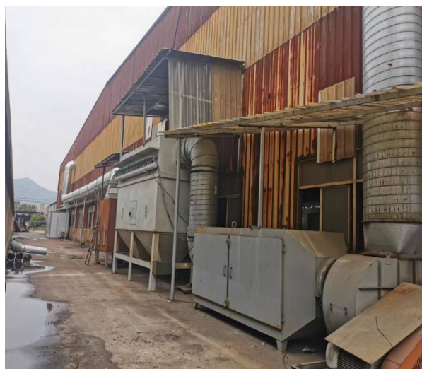
制芯废气处理设施
