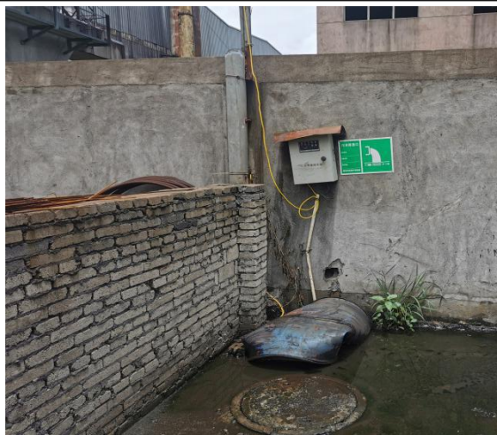
生活污水排放口
