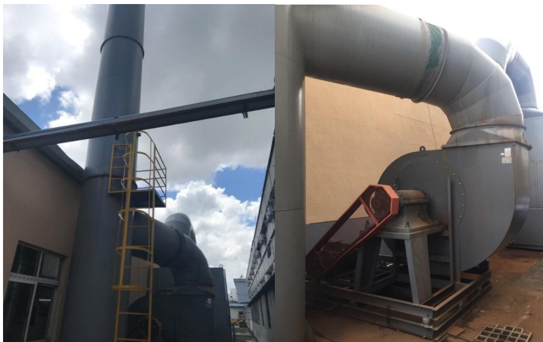
图 3-9 除尘装置（左）和引风机（右）
