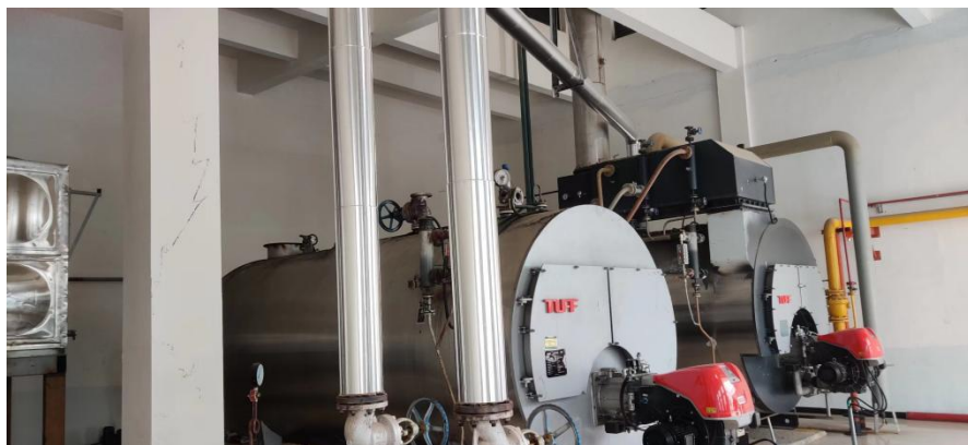
天然气锅炉（6t/h）
