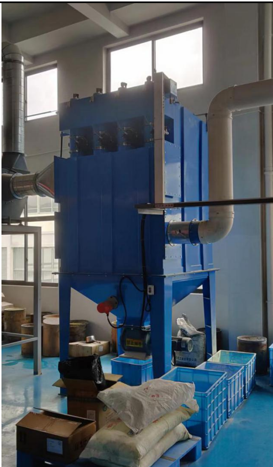
配小料粉尘废气处理设施（布袋除尘器）
