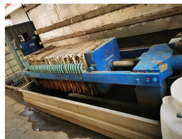
综合废水板框压滤
