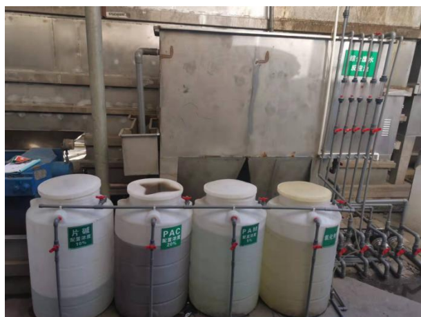
废水处理设施
