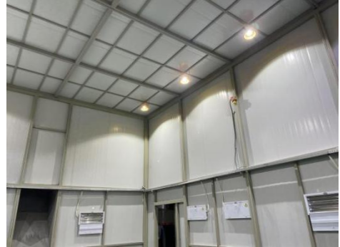
涂刷房收集系统
