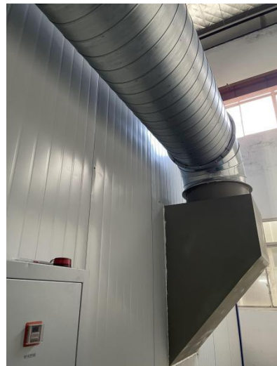
涂刷房收集管道
