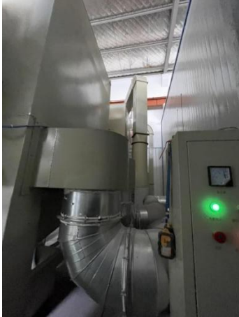
废气处理设施
