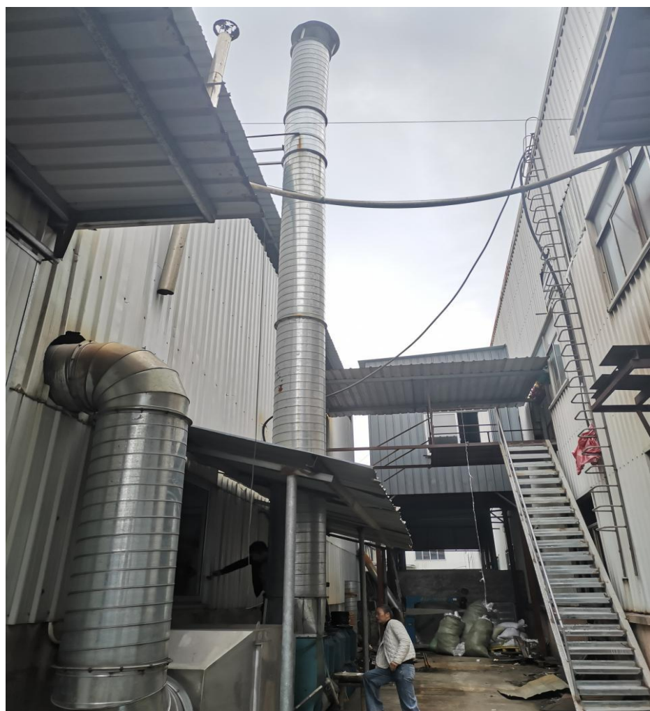
废气处理设施（活性炭吸附）
