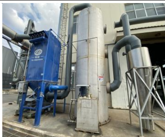
旋风除尘+布袋除尘（水膜除尘器备用）
