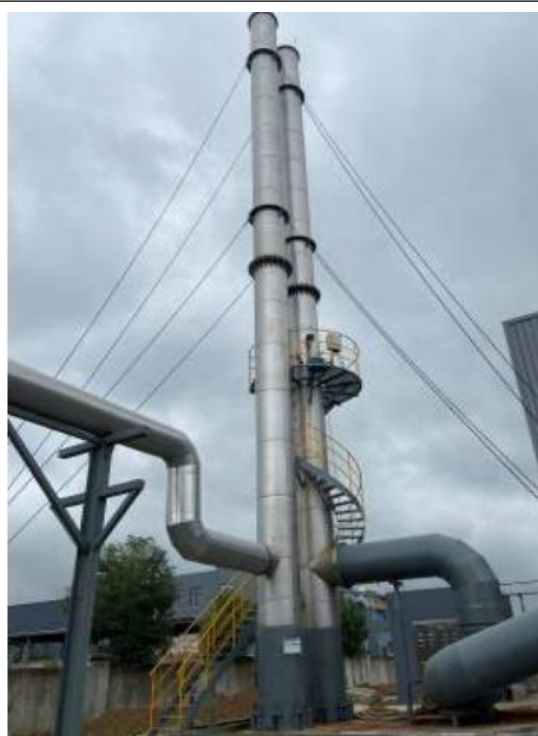
25m 高排气筒（1#、2#）
