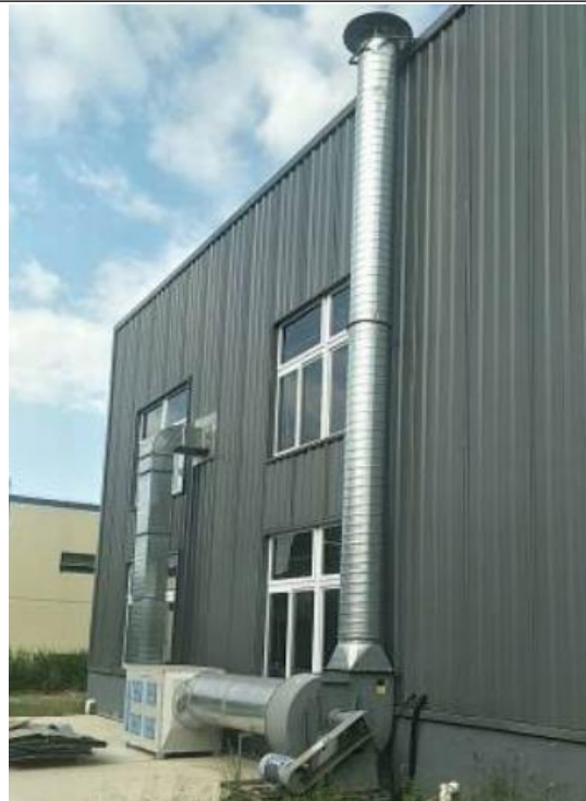
危废仓库废气处理设施
