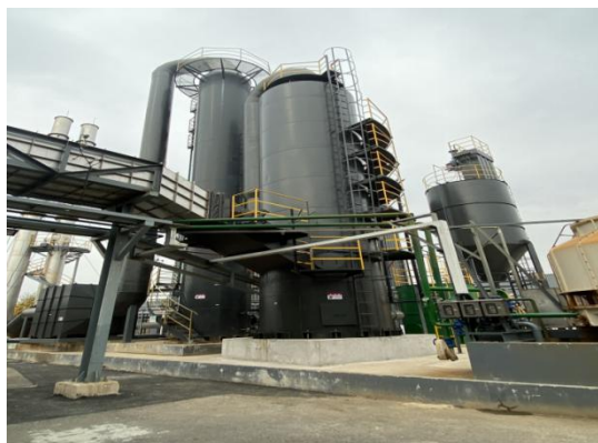
石灰石石膏系统
