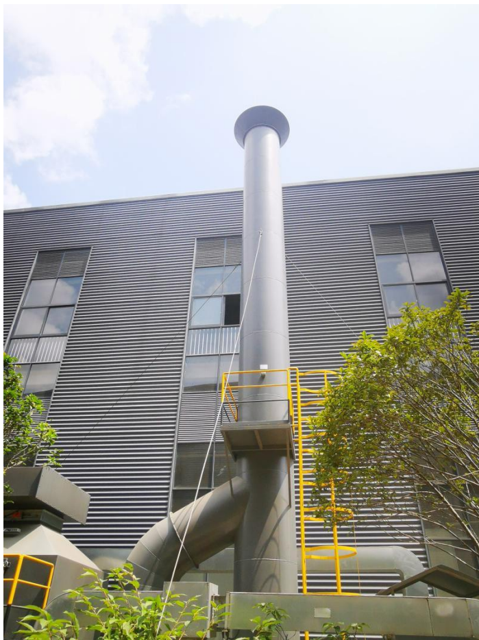
油漆废气处理设施排气筒
