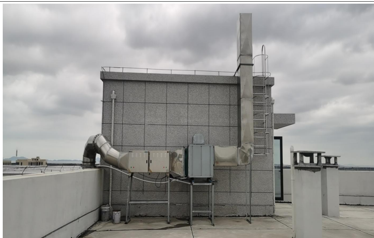
油烟废气排气筒（油烟净化器）
