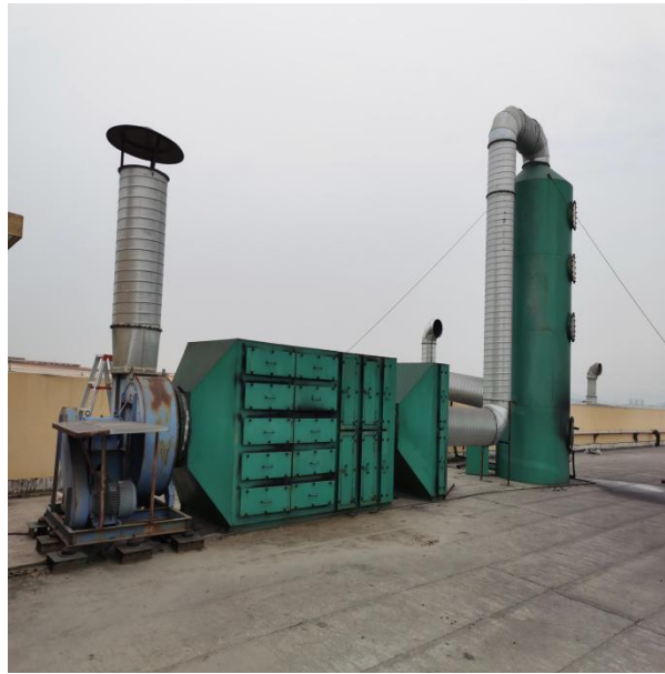
喷漆废气处理设施
