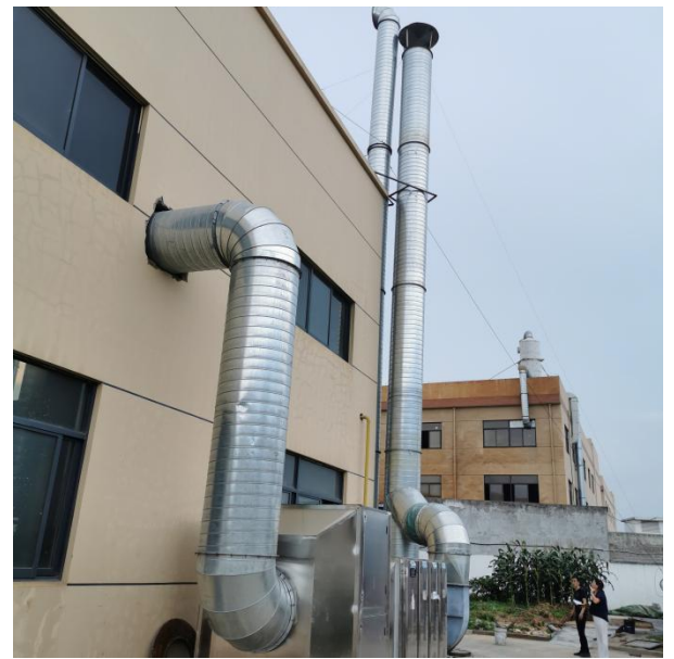
脱模废气排气筒
