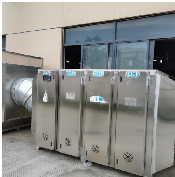
脱模废气处理设施
