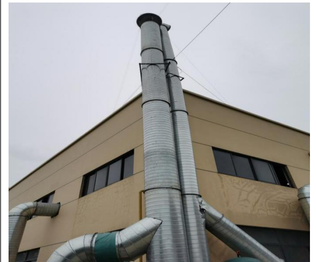
燃烧废气排气筒
