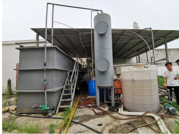
废水处理设施
