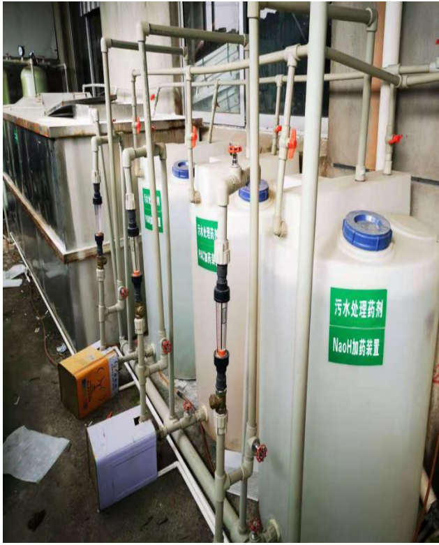
废水处理设施
