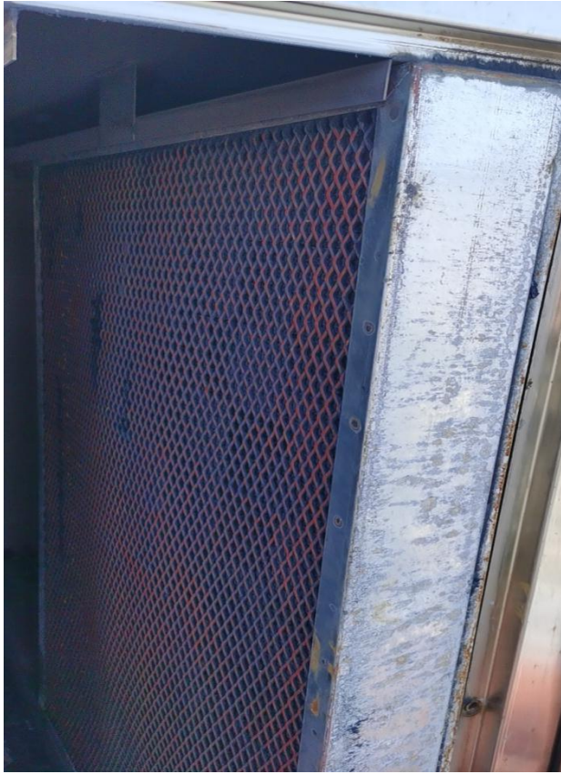
油漆废气处理设施内活性炭箱
