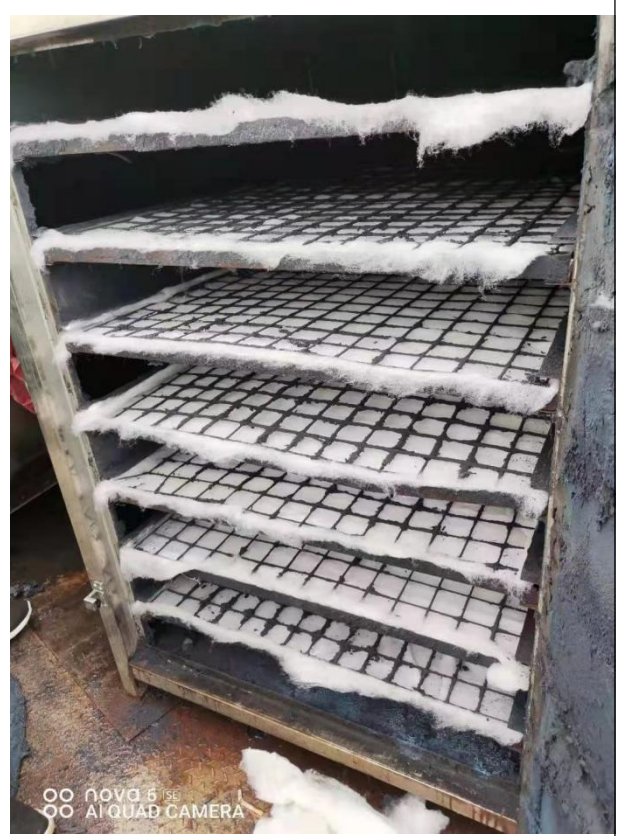
油漆废气处理设施内过滤棉箱
