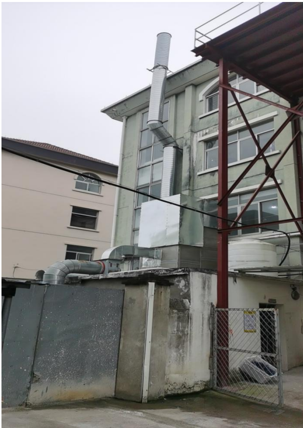
磨水口拉砂抛丸废气处理设施
