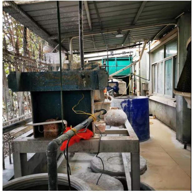
废水处理设施
