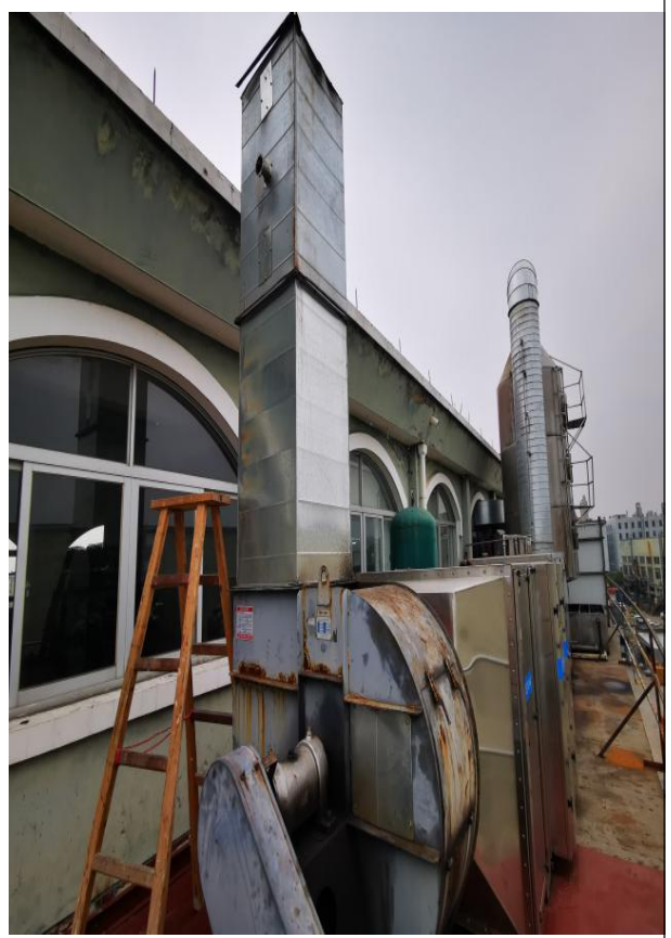
油漆废气处理设施
