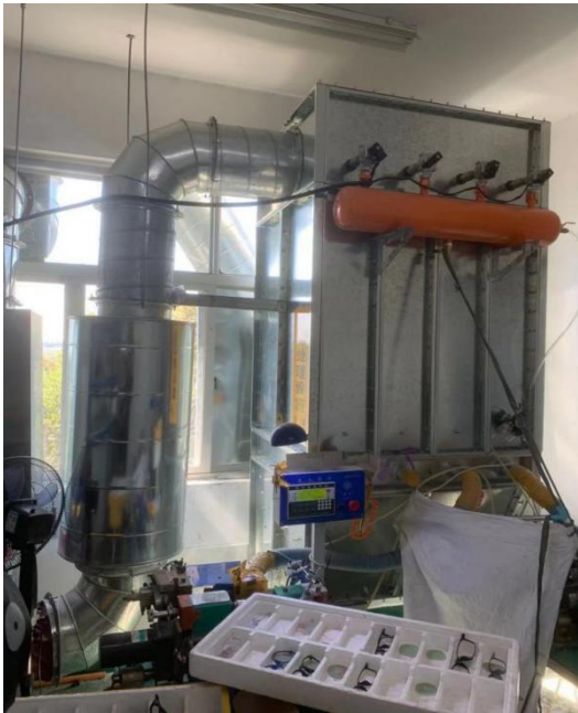
拉砂割片废气处理设施
