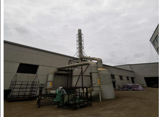
酸雾废气处理设施
