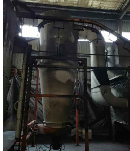
喷塑废气处理设施
