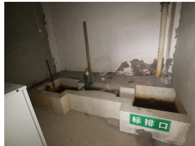
生产废水标排口
