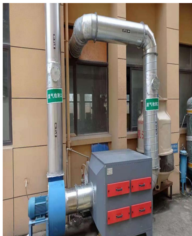
活性炭吸附+高空排放
