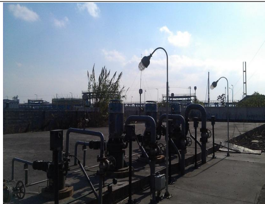
事故应急水池
