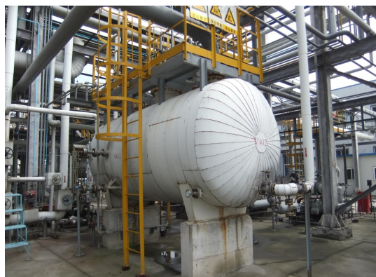
低压瓦斯气收集罐
