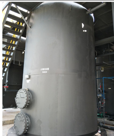
废水处理设施（一级 LFD 反应器）
