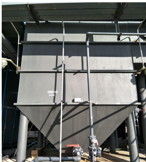
废水处理设施（一级絮凝沉淀池）
