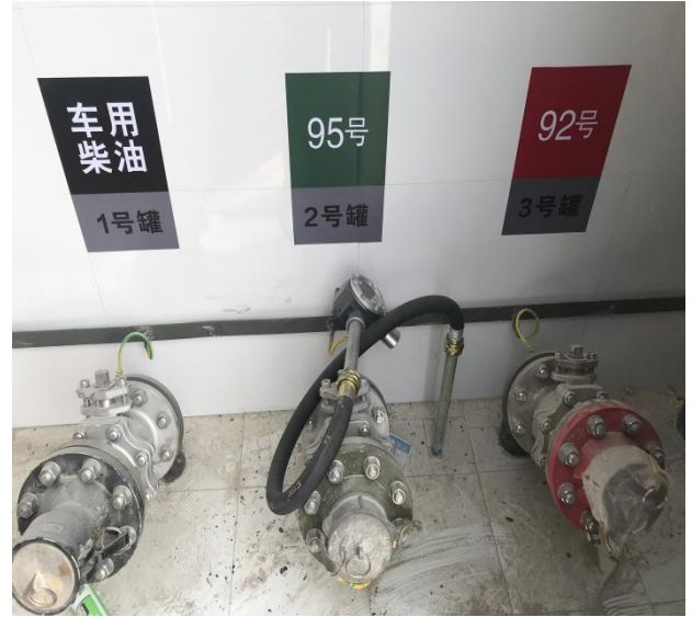
油气回收装置
