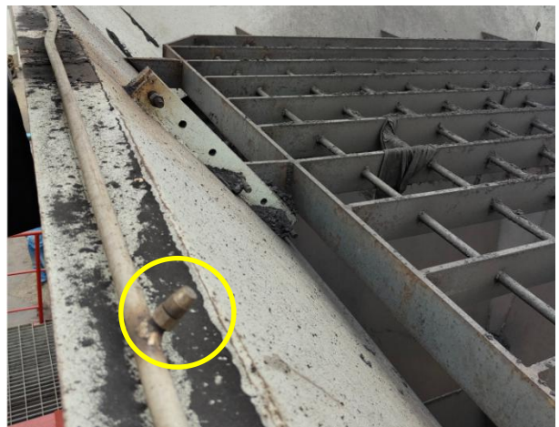
码头燃煤卸料口喷淋头
