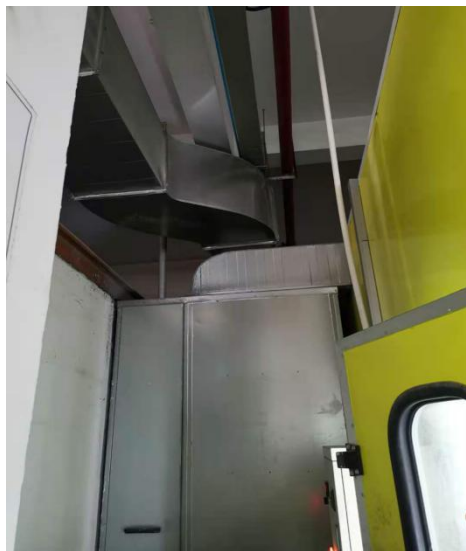
喷漆废气处理设施
