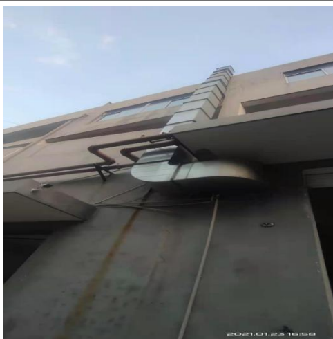
废气排放口（离地 15m）
