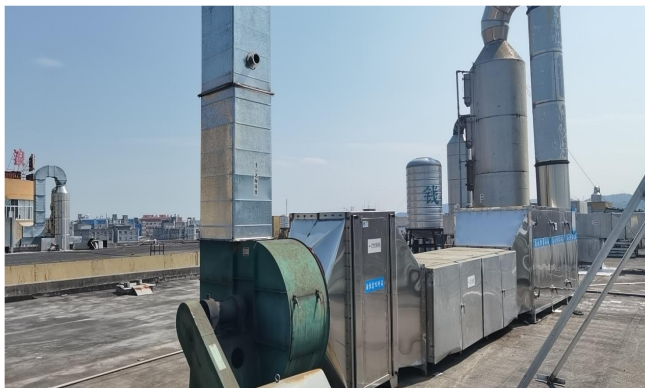
喷漆废气处理设施：水喷淋+除雾棉+UV 光催+活性炭
