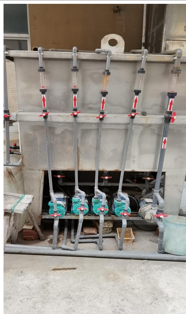
废水处理设施水流向
