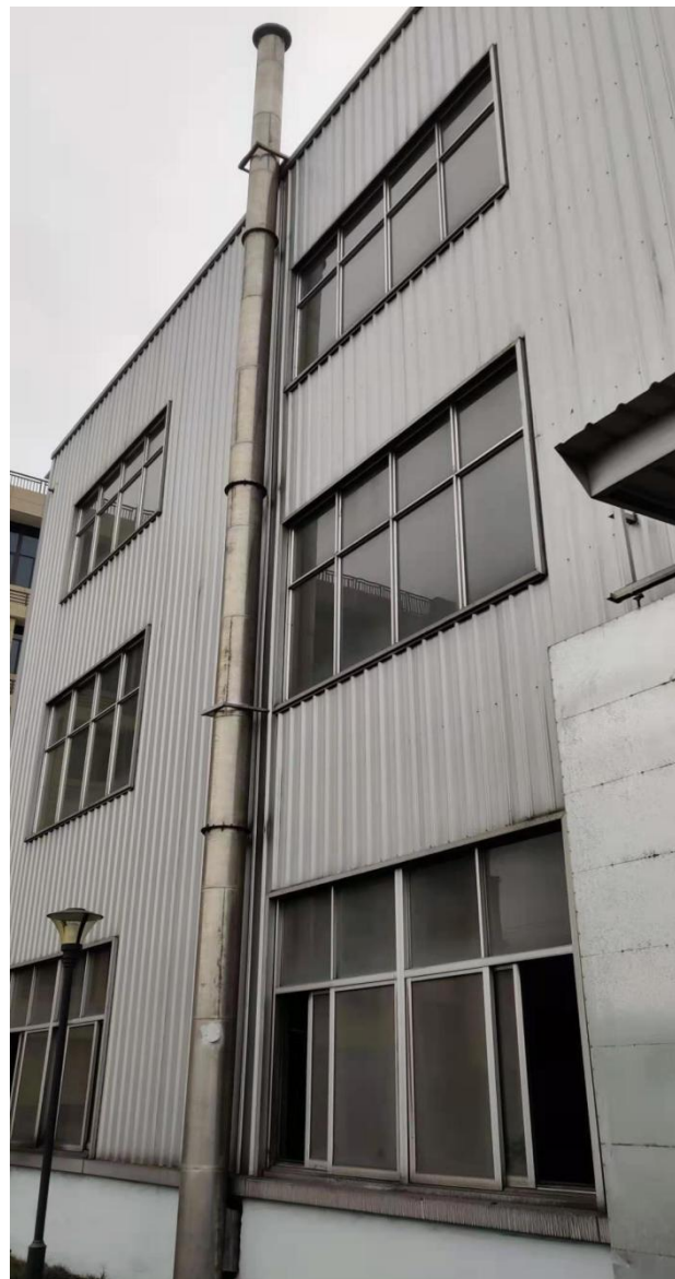
混砂粉尘废气排气筒
