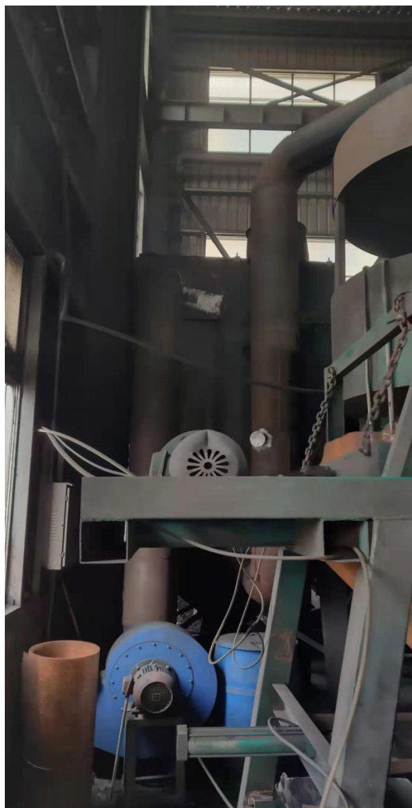
混砂粉尘废气处理设施
