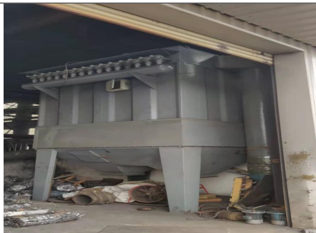
熔炉烟气废气处理设施
