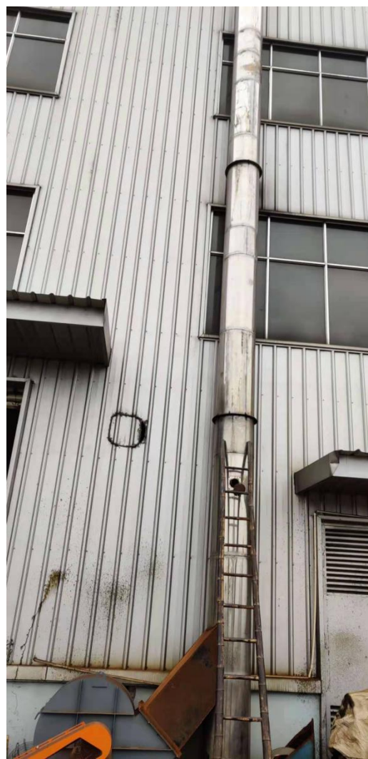
熔炉烟气废气排气筒
