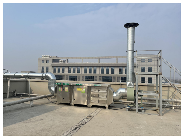
喷漆废气处理设施及排放口
