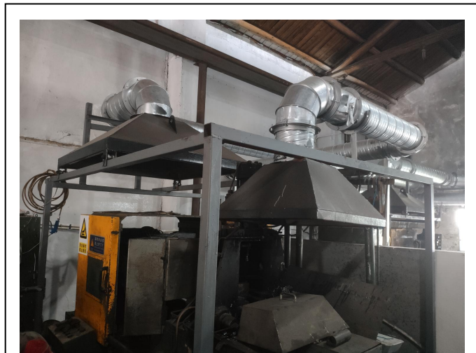
废气收集设施
