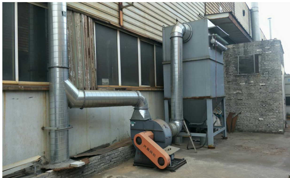
开箱落砂废气处理设施（集气罩+脉冲布袋除尘装置+15m 排气筒）
