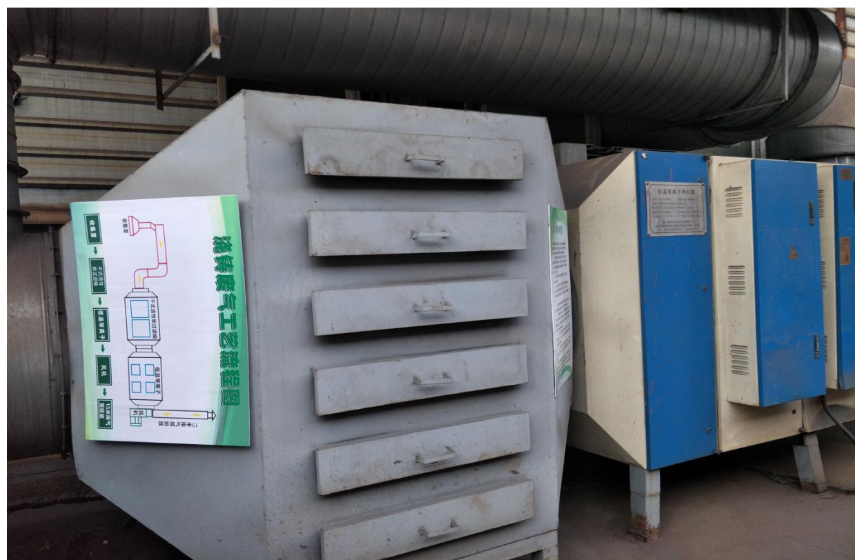
浇铸废气处理设施（集气罩+干式活性炭过滤棉+低温等离子装置+15m 排气筒）
