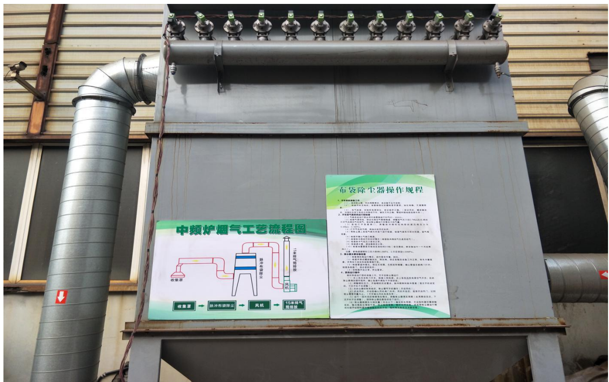
中频炉废气处理设施（集气罩+脉冲布袋除尘装置+15m 排气筒）
